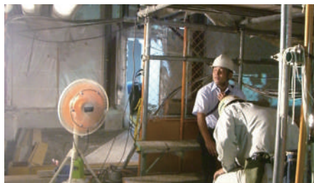
屋内(休憩所)(熱暑対策)
