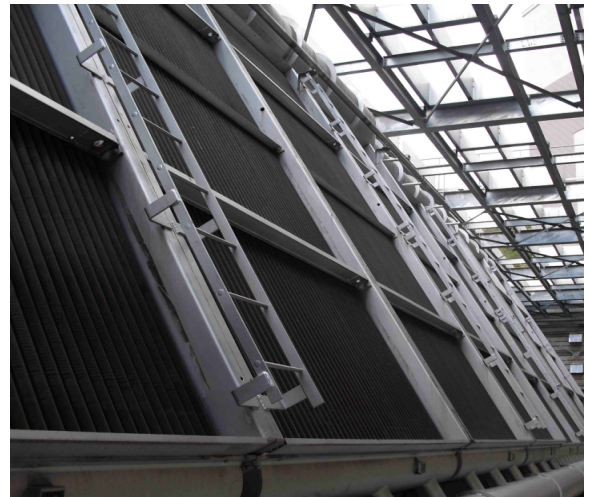
図1 蒸気復水器の外観
